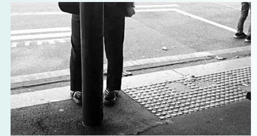
파손된 점자 블록, 어울림누리극장 앞
